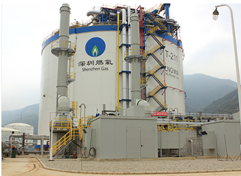
LNG Storage Tanks
